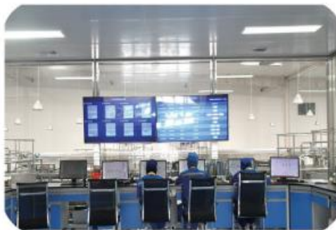
图摄：中央控制室
